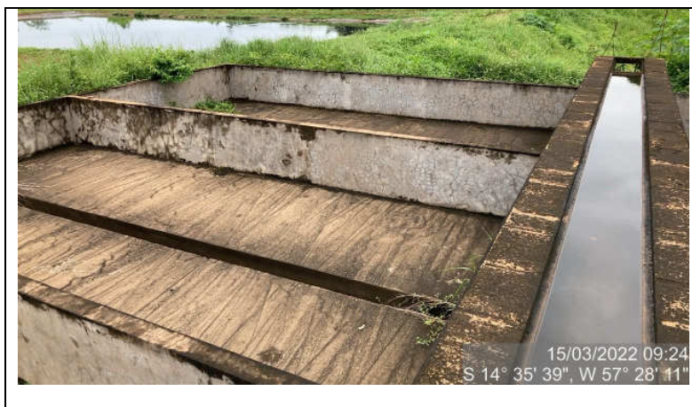
Foto 6.3 – Leito de secagem do lodo
