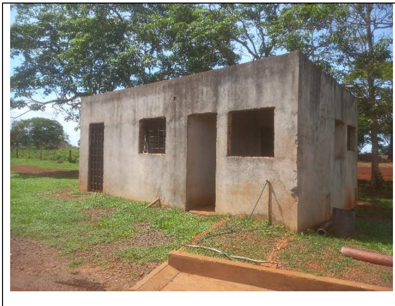
Foto 6.4 – Prédio administrativo semi destruído
