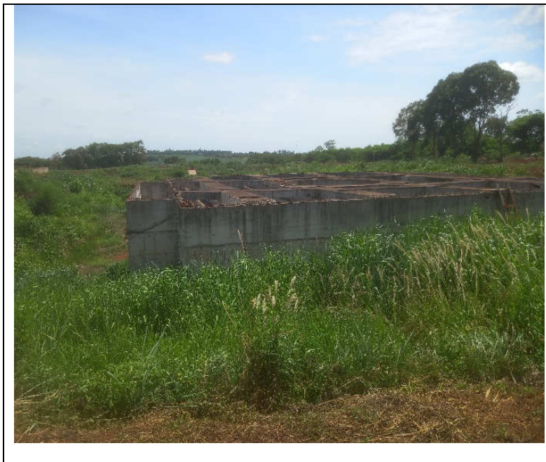
Foto 6.2 – Estrutura do Reator Anaeróbio - UASB
