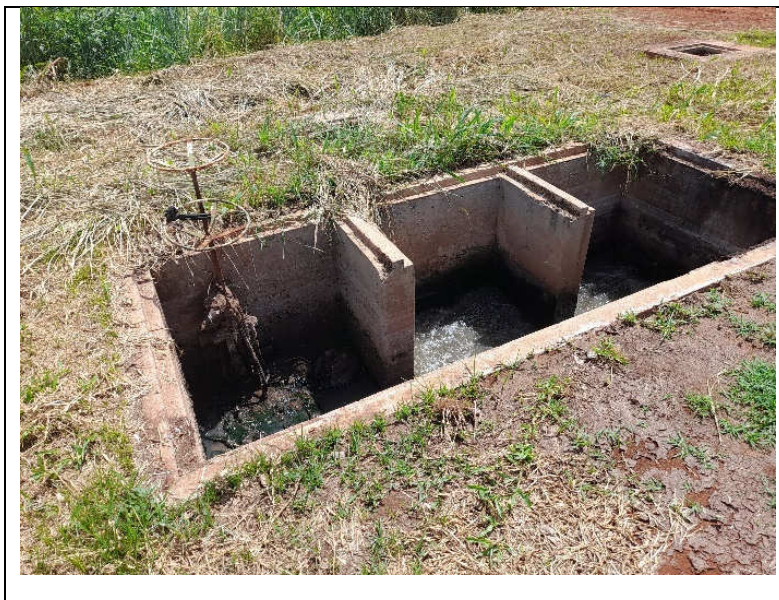
Foto 4.6 - Caixas divisoras de vazão deverão ser cobertas.
