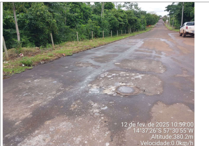
Foto 07 – PV sem extravazão de esgoto, após desobstrução.
