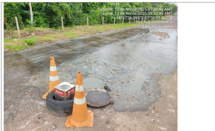
Foto 01 – Poço de visita alagado na Rua Marlene Campos Alves e 19-A
